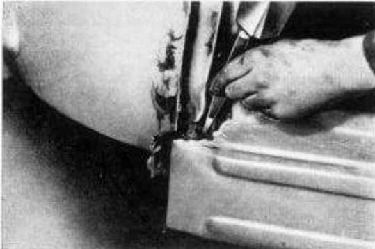
Bild 25. Trennung der A-Schweißverbindung Kastensäule Scharnierseite (Fahrertür) mit Außenhaut vollständig unter der Fahrertür und dem Halter für die Windlaufsäule
